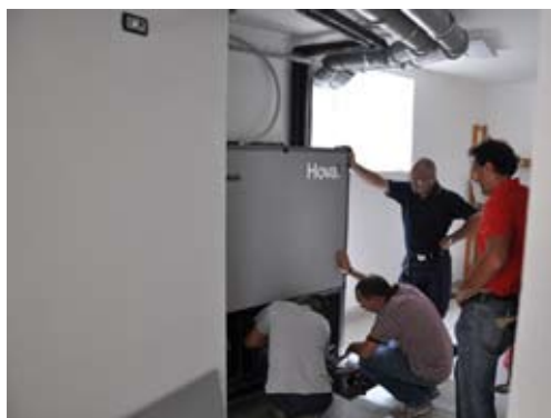
L'installazione della PdC Hoval Belaria®.
